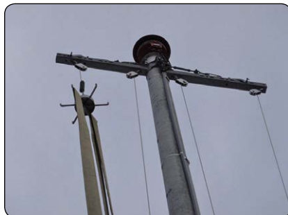
モーターサイレン取付時
