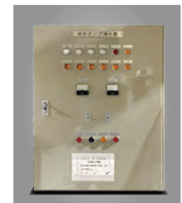
保安ポンプ操作盤
